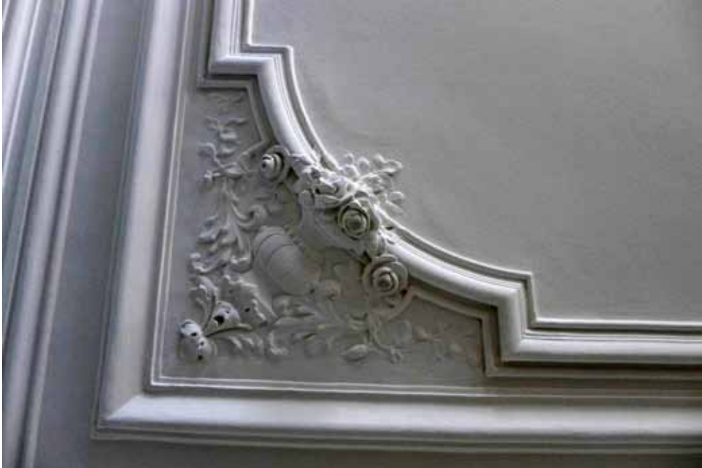
(12) Straßenseitiger großer Raum im Erdgeschoss, 2016 Florale Motive und Blattmaske in den Ecken der Stuckdecke
